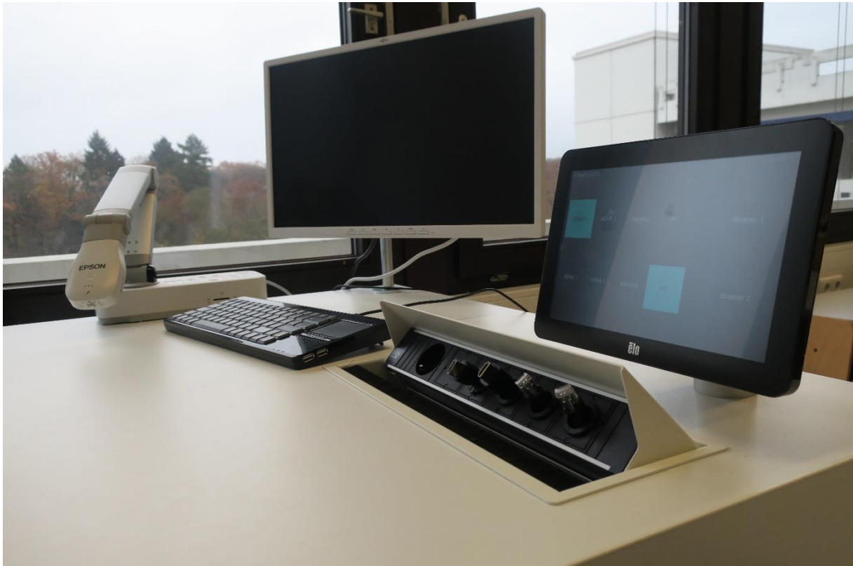
Mediensäule mit PC, Mediensteuerung, Anschlussfeld und Dokumentenkamera.
